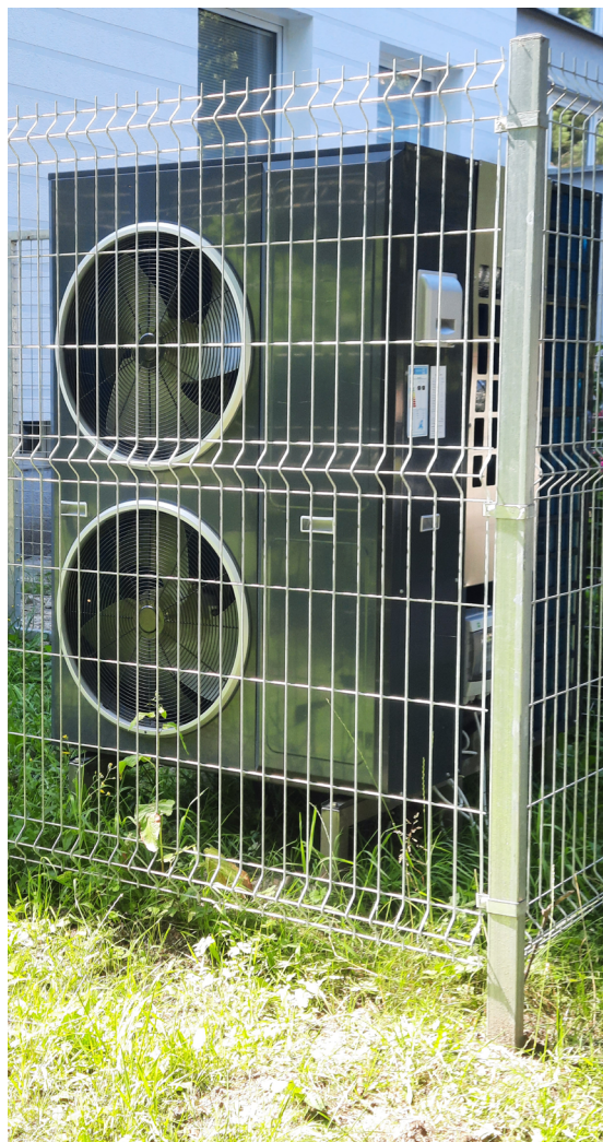
Rys. 1 Pompy ciepła przed blokiem numer 59 należącym do spółdzielni (K. Bogucka-Bykuć, IMP, 2024)
