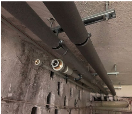
Rys. 3 Rury rozdzielcze CWU (Sebastian Bykuć, 2022)
