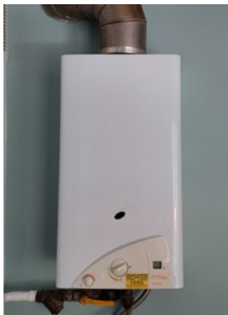
Rys. 5 Indywidualny kocioł gazowy (używany do przygotowania CWU) – planowany demontaż pod koniec lata 2022 (Sebastian Bykuć, 2022)
