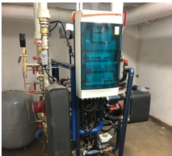
Rys. 4 Zmodernizowany węzeł cieplny z produkcją CWU (Sebastian Bykuć, 2022)
