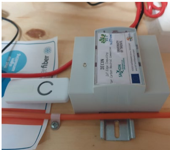
Rys. 1 System IECON zainstalowany w Vriendenerf
